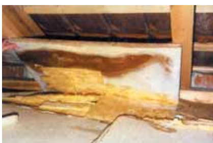
Un problème d'humidité dans un plancher de grenier isolé en raison de l'étanchéité à l'air insuffisante [Foto: Gröger]
