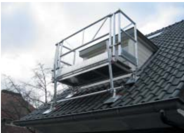
de ArboDak-steiger welke via de ARBO band op het dak is te klikken. De steiger daar waar de veiligheid vereist is en die ten dienste staat van het werk
