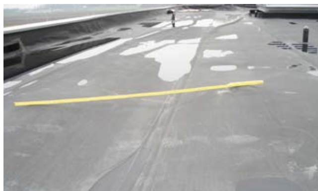
De isolatie is onder de EPDM is over elkaar geschoven.
