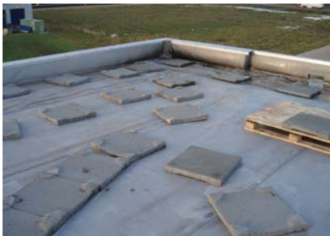
Schade mechanische bevestigde PVC dakbedekkingstelsel
