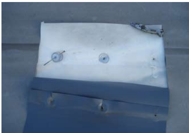
De pvc overlap is ter plaatse van de bevestiging uitgescheurd
