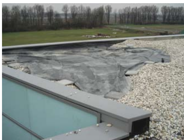
De grind en tegelballast is verschoven
