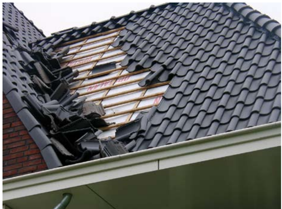
Zware schade in de kil, de verankering ontbreekt
