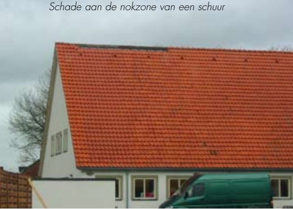
Schade aan de nokzone van een schuur
