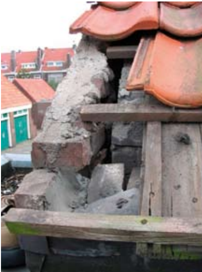
Losgeraakte oude pannen ter plaatse van de aansluiting met kopgevel
