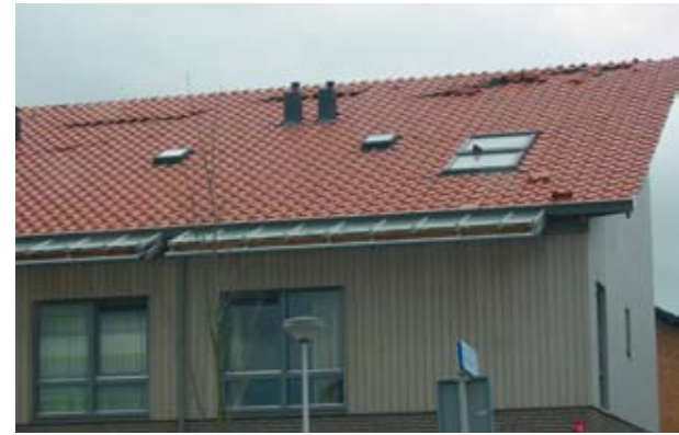
Schade aan de nokzone van een lessenaarskap
