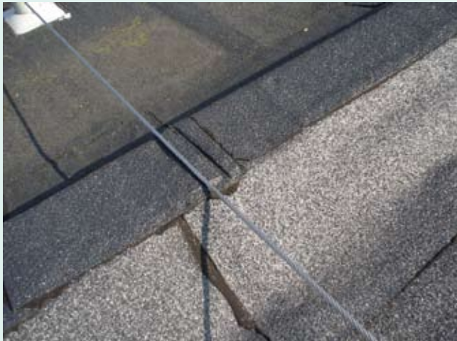
Het kabeltraject is op een voor deze leverancier blijkbaar standaard hoogte gemonteerd. Er is geen rekening gehouden met eventuele opstanden in het dakvlak. Het gevolg is dat de kabel in de waterdichte laag snijdt.
