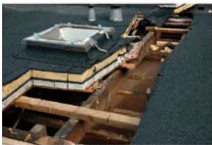
Foto 1 Dakconstructie en afbouw ter plaatse van lichtkoepel
