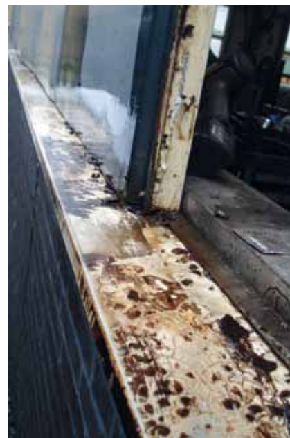
Foto genomen na dezelfde brand in Empel, de lekdorpel van het buurpand (dat dus niet gebrand heeft) nadat de panelen deels zijn verwijderd. Het vuur heeft de isolatiekern van de panelen nauwelijks aangetast.
