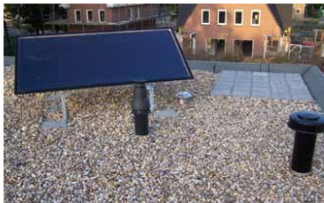
dak met paneel voor zonneboiler
