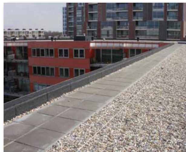
Staalkabel op 2 meter van de dakrand mag niet fungeren als 2 meter afzetting.
