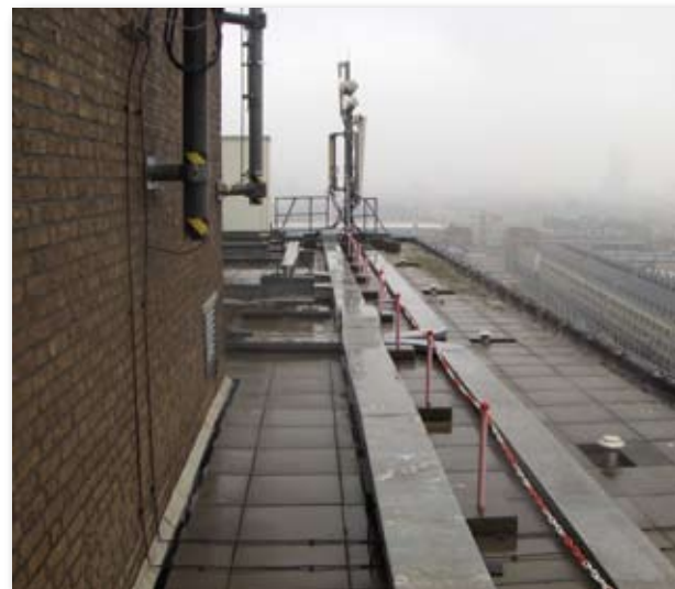
Afzetting van palen met ketting oogt in eerste instantie goed maar heeft niet de vereiste hoogte van >1 meter conform A-blad platte daken.
