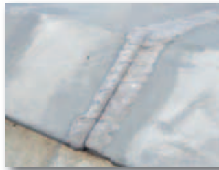
Soleerverbinding laat los
