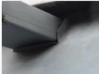
Doorvoer niet afgedicht rondom
