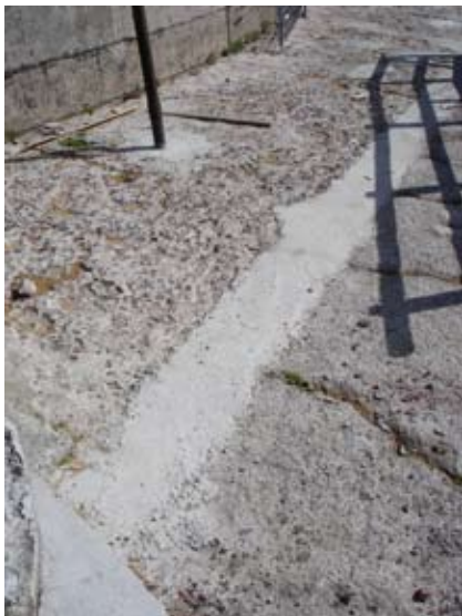
Een dichtgesmeerde scheur in het beton
