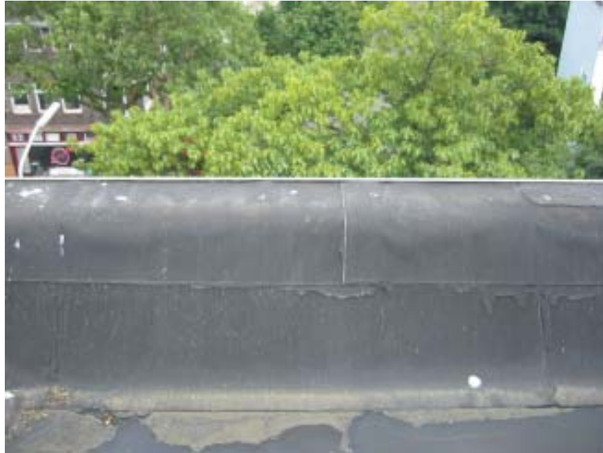
Hier is duidelijk de onthechting waar te nemen tussen trim en dakbedekking.
