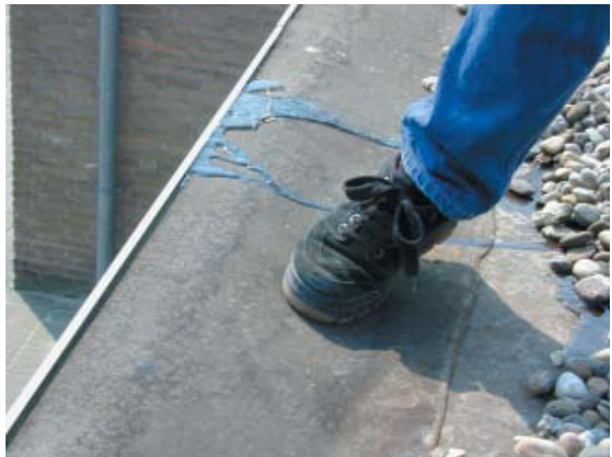
Lekkage bij de rand zijn sluipend. Hier zijn oorzaak en gevolg duidelijk in beeld. Ook is duidelijk te zien hoeveel water er op deze wijze kan inwateren.
