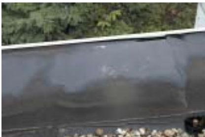
Het bovenvlak is horizontaal. Toch blijft er water op staan met inwatering tot gevolg.
