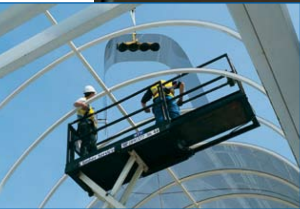
Installatie van de Makrolon-plates in de voetgangerstunnel aan het station van Oostende.
