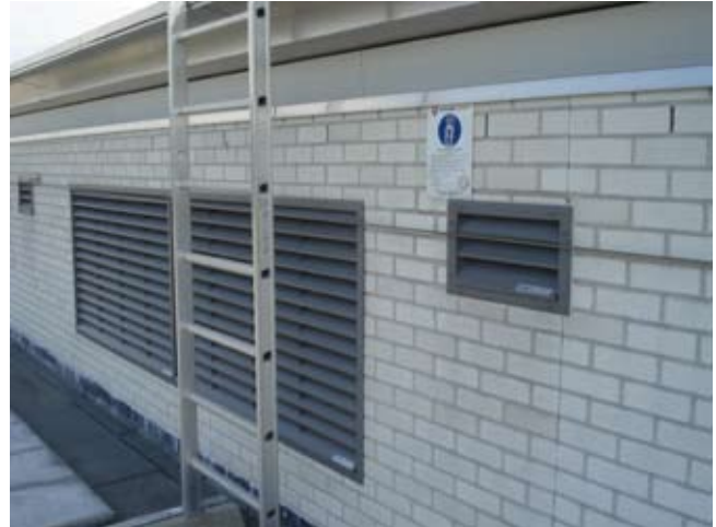
De gevel en aangrenzende dakopstand waar lekkagewater intreedt.
