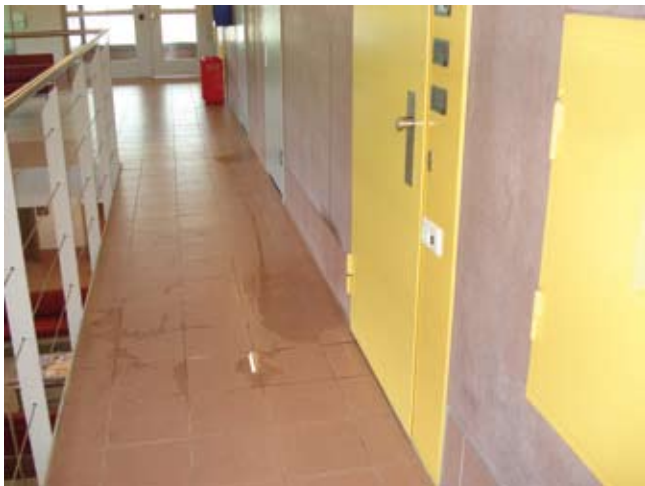
Lekkagewater op de vloer
