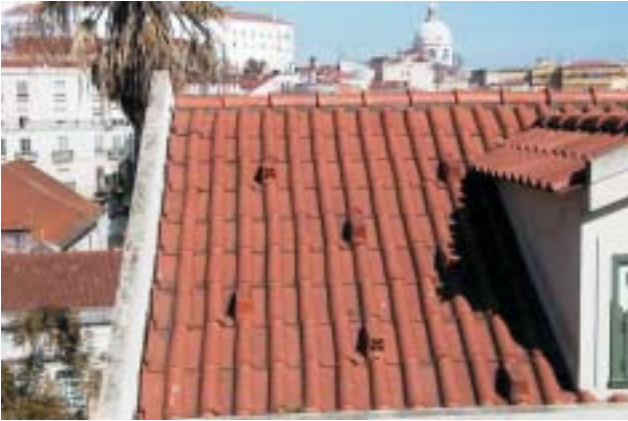
Een dak in Lissabon, voorzien van treden op de pannen. Dit is niet voldoende naar de huidige normen. Het geeft de problematiek voor hellende daken feilloos aan.
