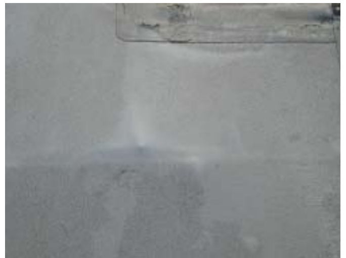
De vervormde isolatie tekent zicht af door het PVC dakbedekkingssysteem.
