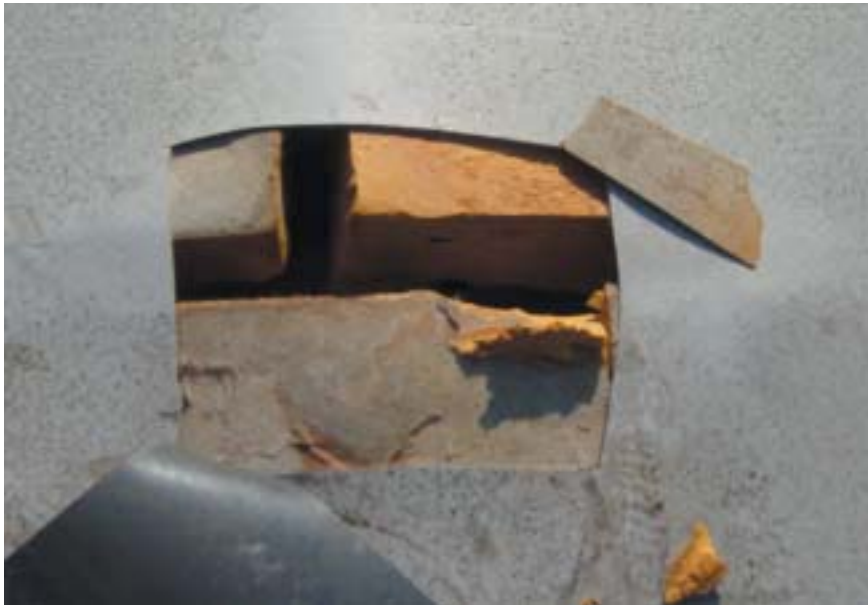
De resolschuim isolatie is ernstig vervormd en breekt krakend bij het belopen van het dak.
