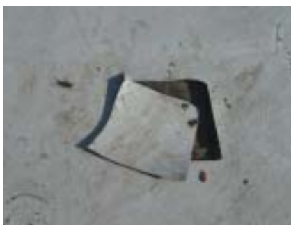
Vocht toetreding door mechanische beschadigingen in het PVC dakbedekkingssysteem.
