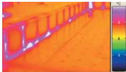
Met behulp van de warmtebeeld (infrarood) camera worden de isolatielekken, ter plaatse van naden en detaillering, inzichtelijk gemaakt
