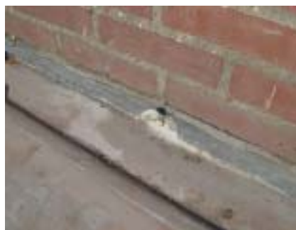
Vocht toetreding door gebrekkige dak- en bouwtechnische detaillering
