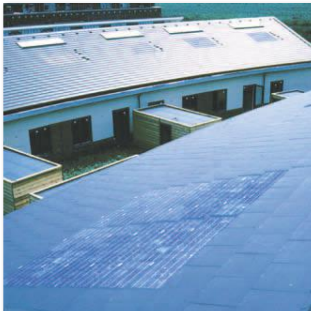
Een goede en mooie oplossing: het PV systeem is tussen de dakpannen in het dak geïntegreerd.
