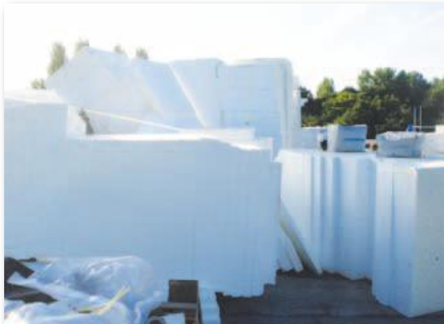
Opslag van isolatie voldoet niet.
