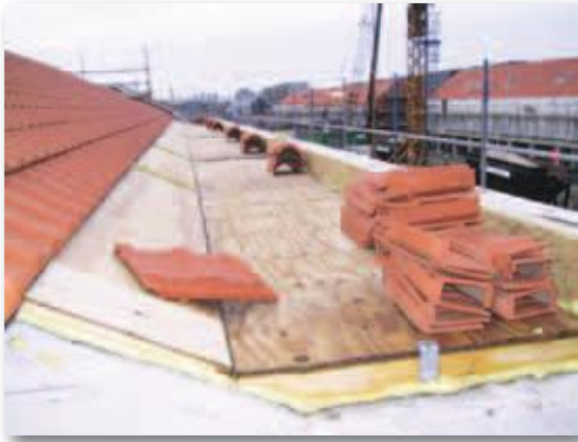
Figuur 7b: Geen bouwfysisch probleem! Wel inwatering tijdens bouw.
