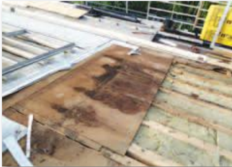
Figuur 5a: Schade aan dakbeschot als gevolg van condensatie door lucht- en damp lekkage vanuit de ankerloze bouwmuur.
