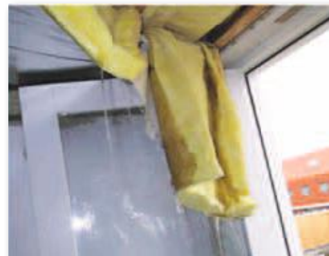
Figuur 7a: Deze hoeveelheid water* is NIET het gevolg van condensatie door lucht lekkages. Nee, hier is sprake van bouwvocht.
