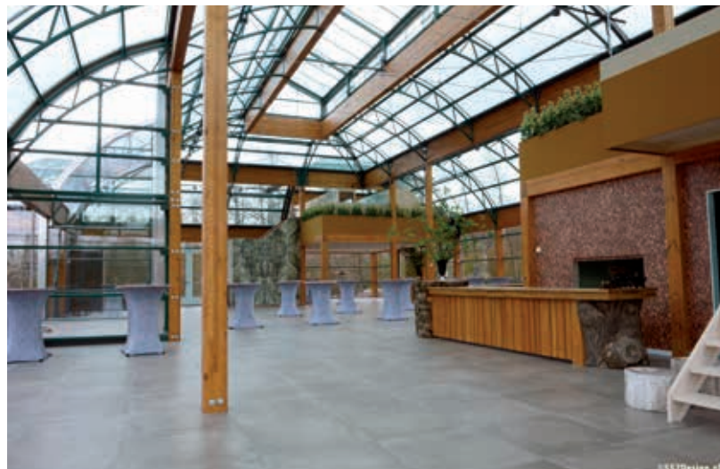
De opname vanuit de ontmoetingsruimte geeft een goed beeld van de opbouw van de dakconstructie met de houten kolommen, ringbalken en stalen vakwerkspanten en gordingen.
