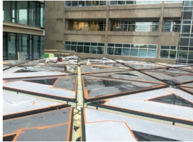
De basisprofielen van de piramides zijn geplaatst en het aanbrengen van de isolatie in de goten is in volle gang.
