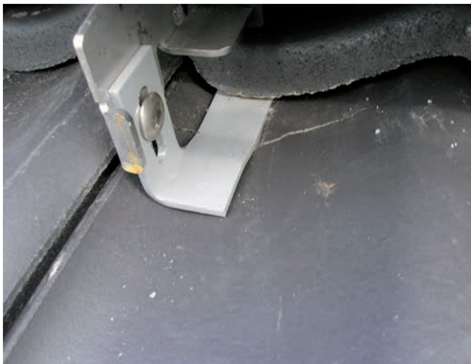
Praktijksituatie gebroken dakpan door puntbelasting van dakraak
