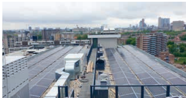
PV dak met installaties en een liftpbouw. (Foto: De Bruijn Dakbedekkingen)
