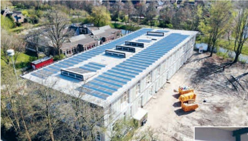
< Stalen dak met 308 zonnepanelen.
