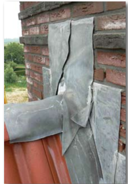
Geen voorziening tegen opwaaien; lood boven nok te hoog ingevoegd.
