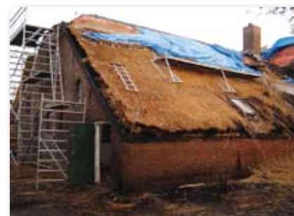
Fig. 2-5 Gebouw met schroefdak tijdens de brand.
