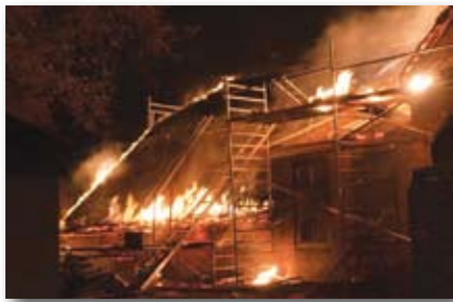
Figuur 2-6 Gebouw met schroefdak na de brand.
