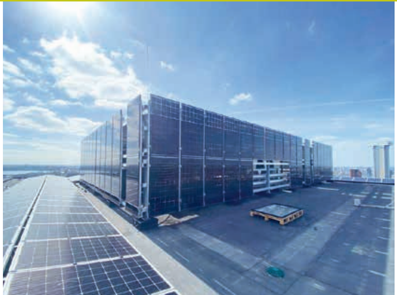
Zonnepanelen op het dak en rondom de installaties.
